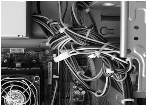
图 2-18 机箱内部线缆固定图
